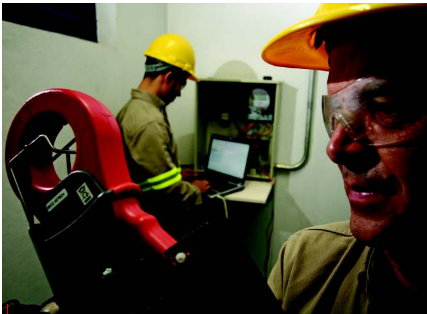
Medição dos transformadores: garantia de consumo correto.
