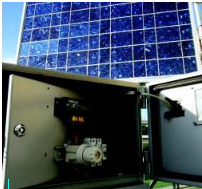
Sistema fotovoltaico: 2,5 mil escolas e residências rurais eletrificadas.
